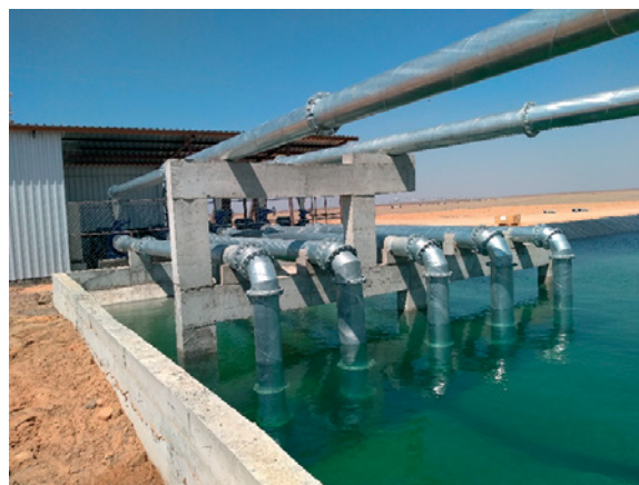
Figura 5 – Sistema de captação de água
